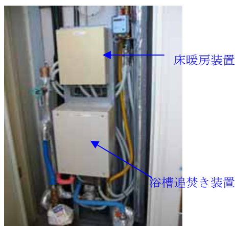
図 1.3 パイプシャフト内機器
