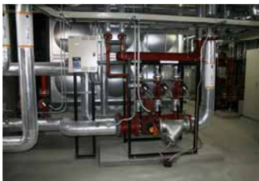
図 9 温水循環ポンプ
