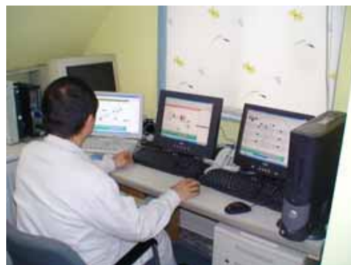
図 1.4 集中監視センター
