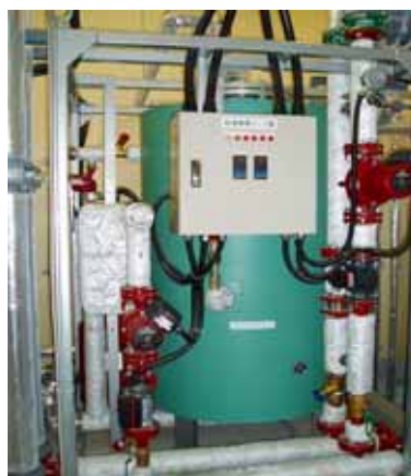
図 11 ブースター熱交換ユニット
