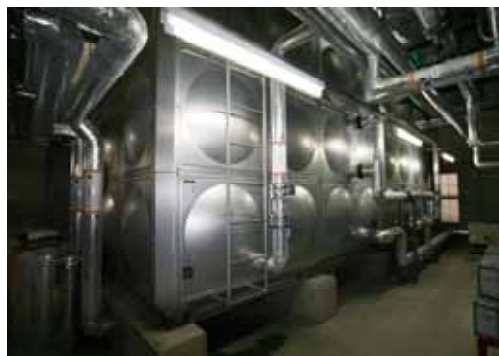
図8 熱回収ストレージタンク
